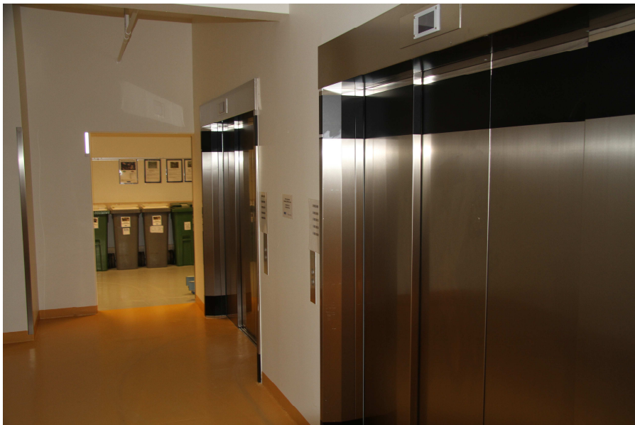
Foto 10: Dobbelt godselevator ifm forsyningsstation
