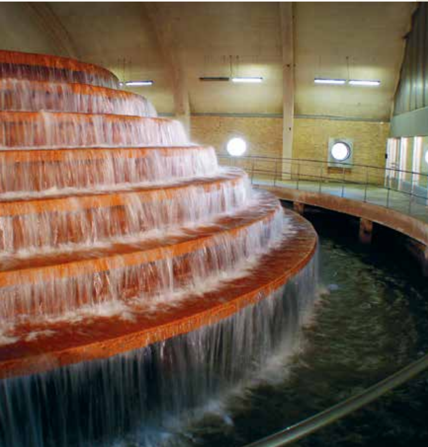
Simple vandbehandling på et dansk vandværk.
