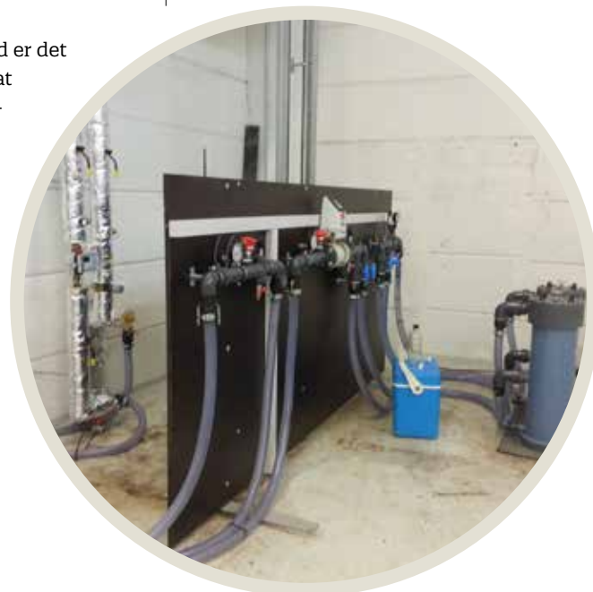
Recirkulationsanlæg og varmepumpe i forsøgsprojektet i Birkerød.
