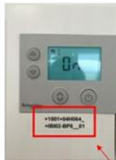
Figur 3: Rum-betjeningspanel (temperaturføler samt betjening)
